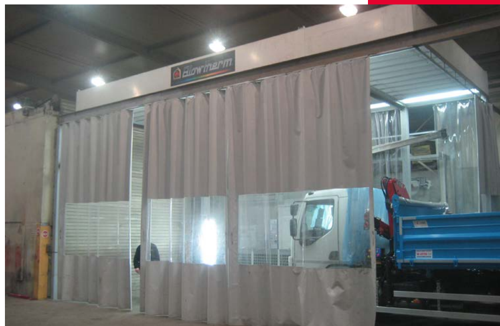
Uruchomienie nowoczesnej hali serwisowej oraz strefy technologicznej na lakierni. Introduction of a new service hall and technological zone in the paint shop.
